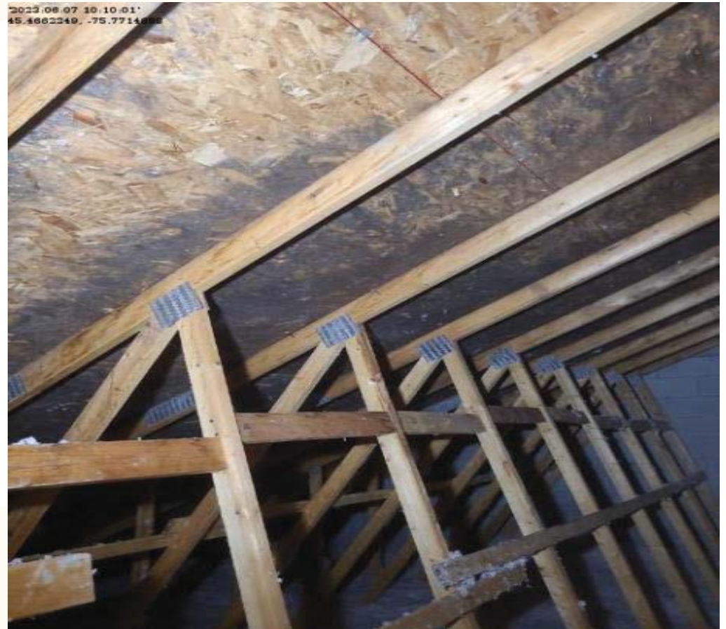
Figure 2 – Rapport externe n° 1 - Moisissure sur le revêtement de l'entretoit (2023-06-07)
