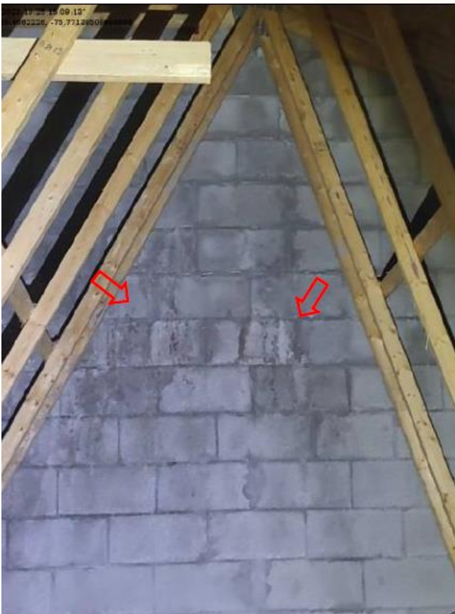
Figure 7 - Rapport externe n° 2 - Signes moiteurs sur le mur mitoyen et l'isolant (2023-10-25).
