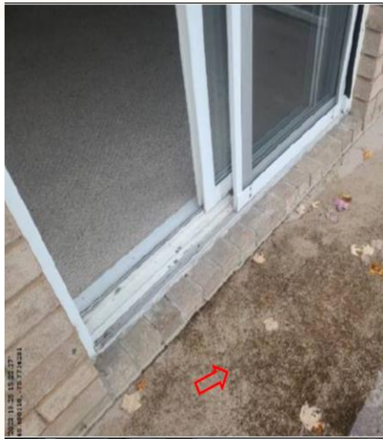
Figure 8 - Rapport externe n° 2 - Accumulation d'eau sur la terrasse et une pente négative vers la porte-patio (2023-10-25).
