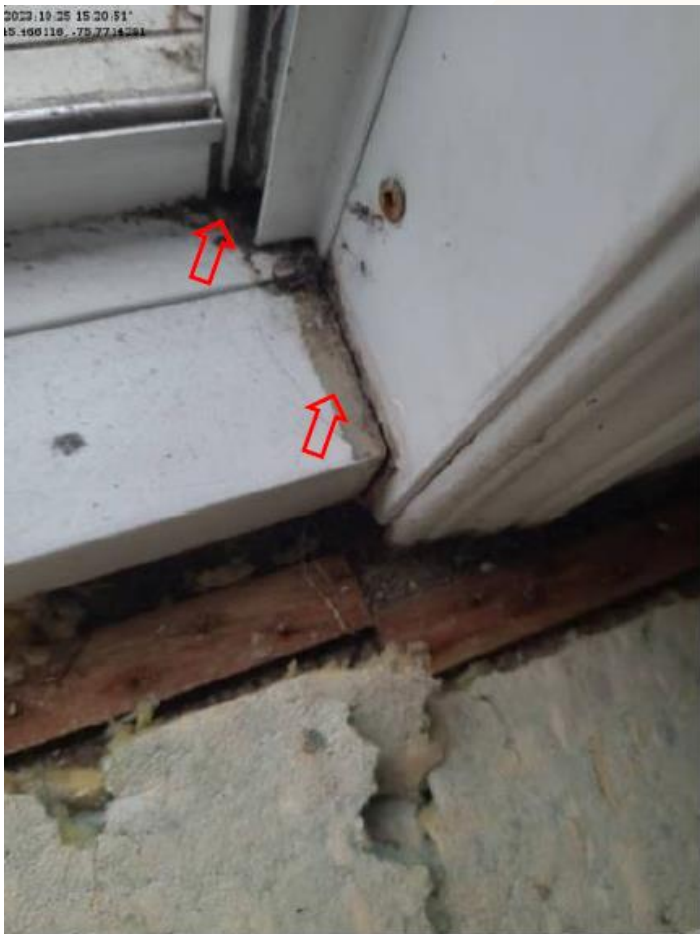
Figure 9 - Rapport externe n° 2 - Moisissure sous le seuil de la porte-fenêtre du balcon (2023-10-25).
