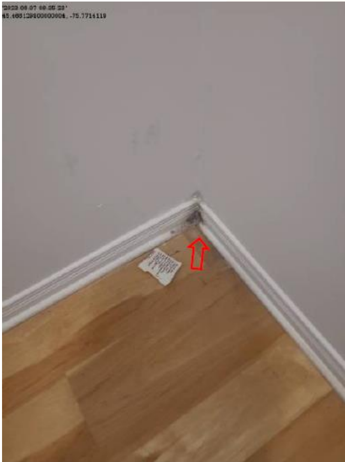
Figure 1 – Rapport externe n° 1 - Moisissure sur le mur du Garde-manger - (2023-06-07)
