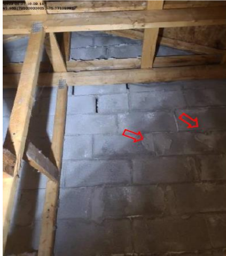
Figure 4 – Rapport externe n° 1 - Signes moiteurs sur le mur mitoyen (2023-06-07).
