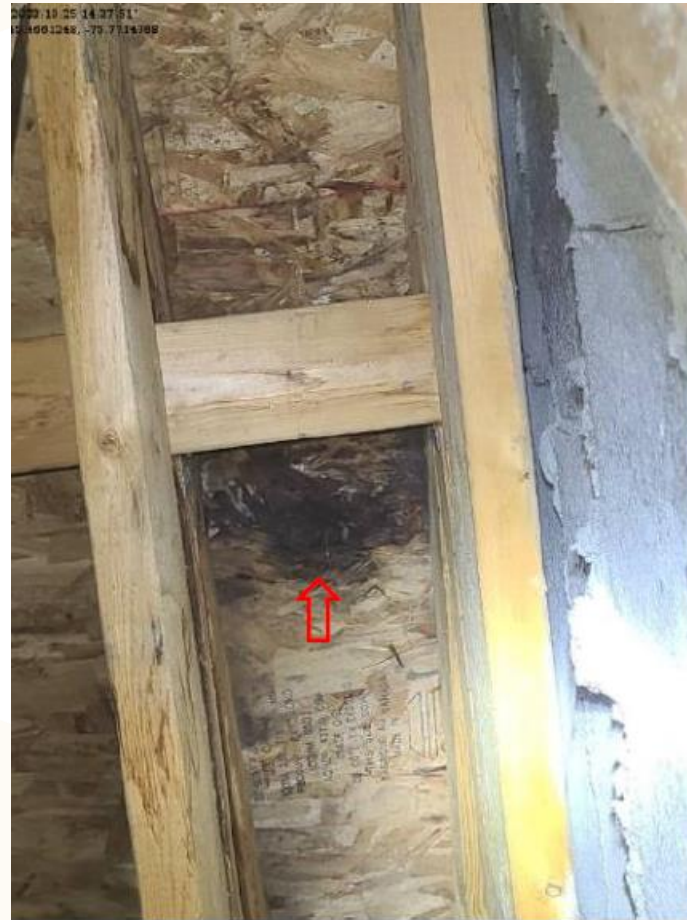
Figure 6 – Rapport externe n° 2 - Réapparition de la moisissure et moiteur sur le revêtement OSB (2023-10-25).
