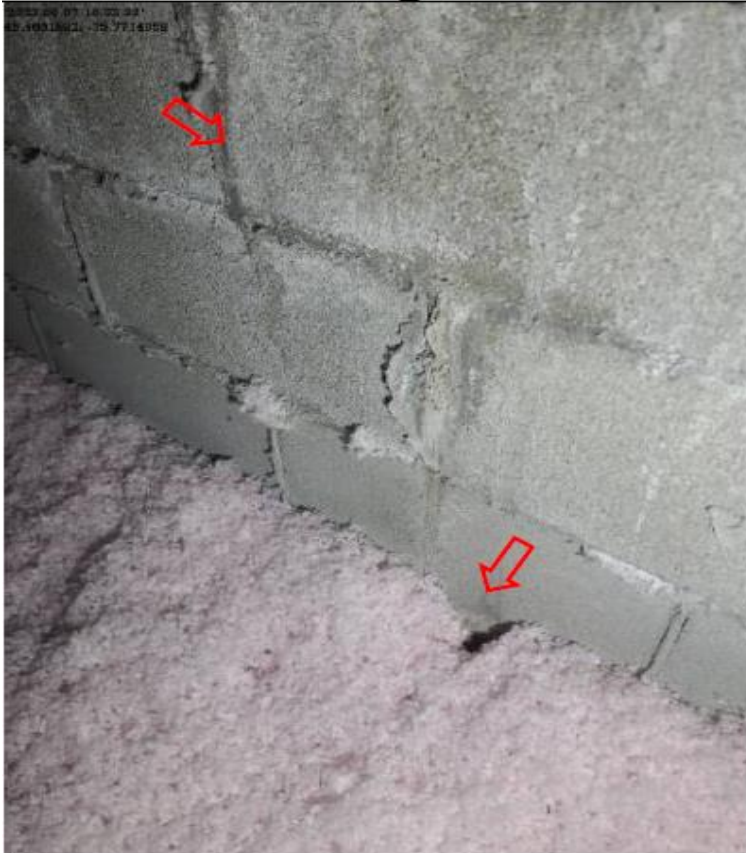
Figure 3 – Rapport externe n° 1 – Signes moiteurs sur le mur mitoyen et l'isolant (2023-06-07).
