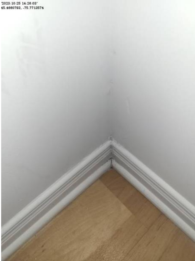
Figure 5 – Rapport externe n° 2 - Moisissure recouverte avec de la peinture (2023-10-25).
