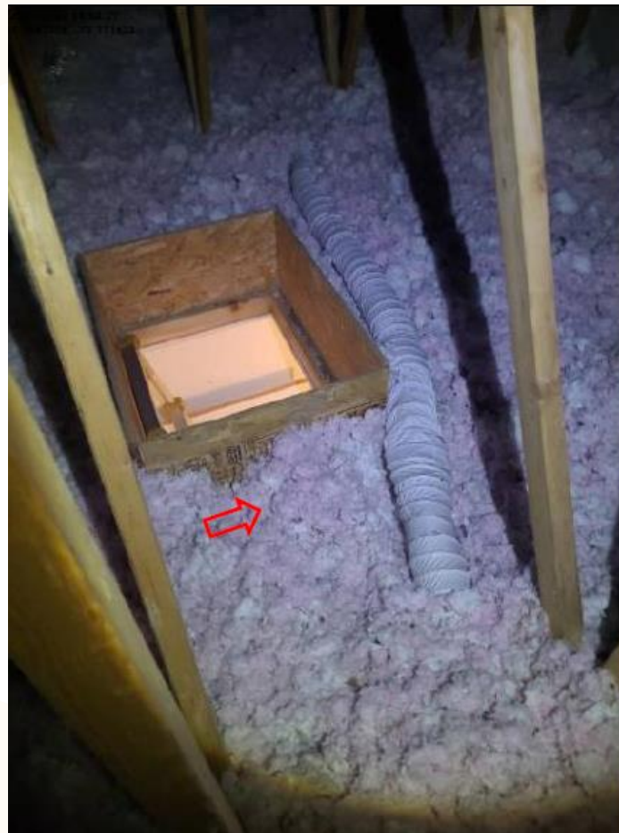
Figure 10 - Rapport externe n° 2 - Conduit ventilateur de sécheuse non isolé, risque de condensation et de moisissure (2023-10-25).
